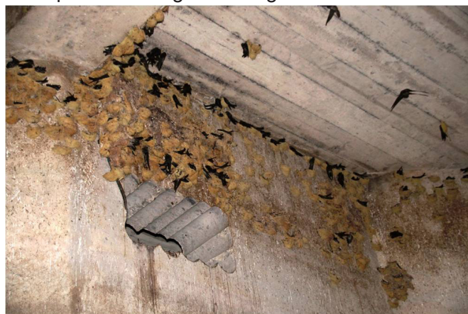
Colonie de Salanganes des Mascareignes dans le dégraveur d'un captage d'eau - François-Xavier COUZI.
