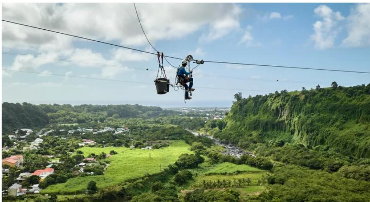
Pose des balises sur le site de Rivière du Mât le 7 juin 2023 par un agent EDF
